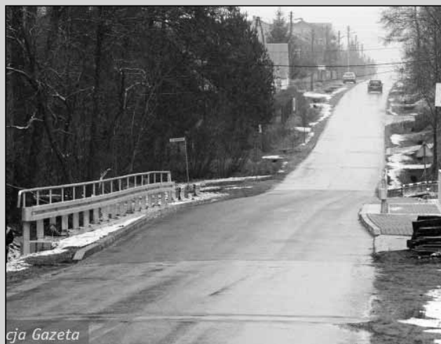
Dzisiaj most ten już nie istnieje (został wyburzony w 2011 r., po ponad 80 latach funkcjonowania) – zastąpiono go nowym, z wmurowaną weri belką, z historycznym napisem. Na fotografii – nowy most w Słowiku w trakcie budowy (2014)
